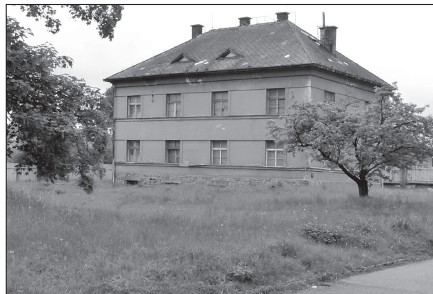
Obr. 1. Bývalá důstojnická vila, stav před rekonstrukcí, květen 2009. Foto M. Lang.
