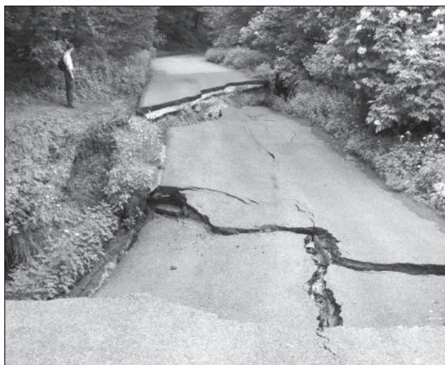
Obr. 1. Sesuv části silnice mezi obcemi Mořina a Karlštejn, červen 2013. Foto K. Žák.
