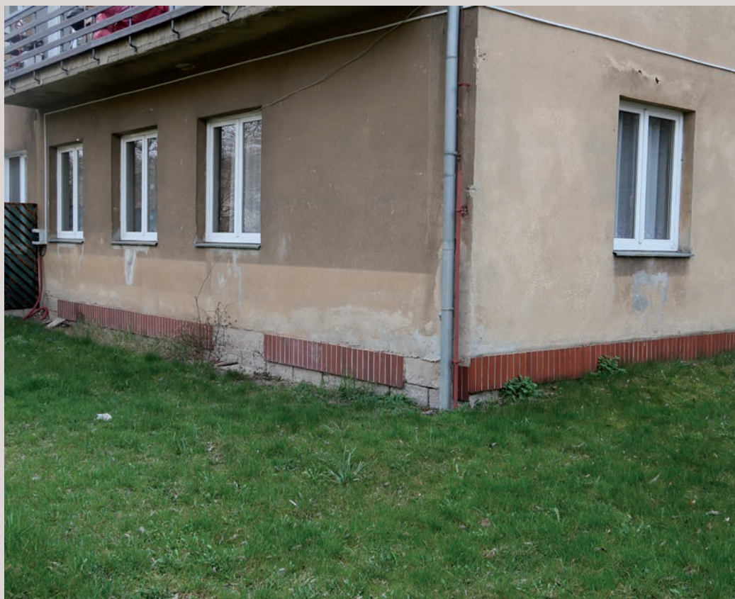
Obr. 13. Povodňové čáry na domě čp. 102 v Loděnici. Dochovaly se díky tomu, že dům má velký převis střechy a stěny nejsou omývány deštěm. Spodní hladinová čára odpovídá roku 2013, horní roku 1981. Foto K. Žák.
